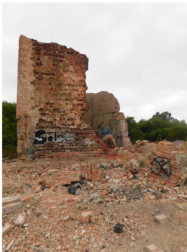
Figura 4 Restos de la chimenea principal de la antigua fundición de Pb en Matehuala. Se observan los restos de la construcción altamente contaminados por As, Pb, Cd, Cu y Zn en contacto con el suelo.
